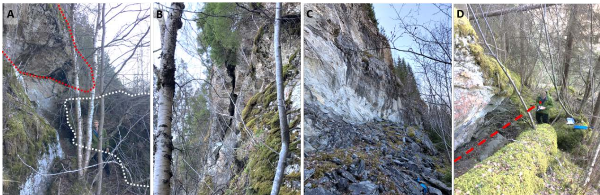
Figur 19. A og B: sprekkeavløst bergparti (rød stiplet linje) og stort blokkutfall (hvit stiplet linje). C: Bergskrent inntil prosjektert skjæringstopp ved profilnummer ca. 21950. D: Svakhetssone med orientering 50/155 ved profilnummer ca. 21850.
