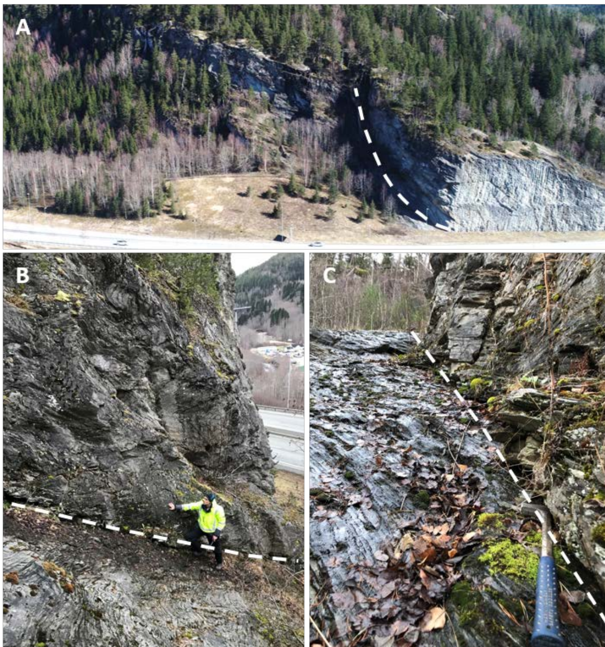
Figur 20. Markert sprekk og glideplan langs i nordenden av eksisterende bergskjæring. Hvit stiplet linje markerer sprekken. A: Oversiktsbilde. Eksisterende bergskjæring er omkring 28 m høy. B: Hjørnet av eksisterende skjæring sett fra nordsiden. Personen på bildet står på plan med orientering som sett C og har hånden på plan med orientering som sett A. C: Glideplanet sett nedenfra.
