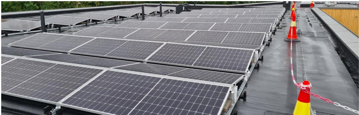
Solceller Fossli omsorgssenter (Foto: Veidekke)
