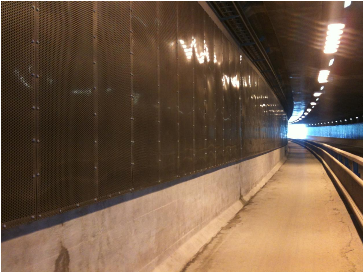
Støyskjerming langs E6 i kulvert under flyplassen. Her er det lagt støydempende plater i tak over gang- og sykkelvegen og på veggene på begge sider av vegen.
