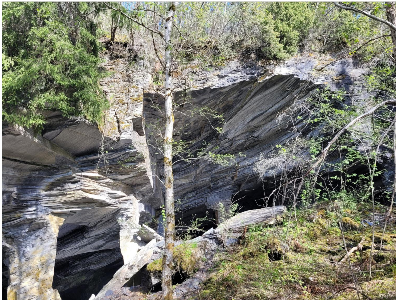
Figur 9 Bilde av hovedskiferbruddet som viser pilarer samt nedfall av blokker og stein i bruddet
