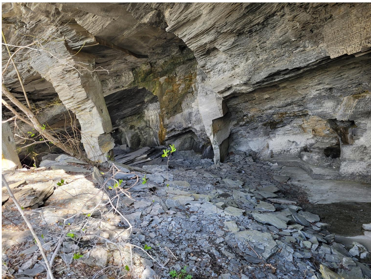
Figur 12 Bilde av hovedskiferbruddet som viser pilarer samt nedfall av blokker og stein i bruddet
