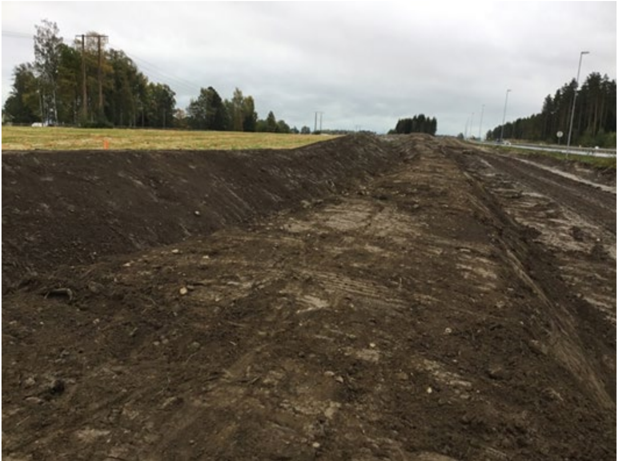
Figur 22 Midlertidig masselagring av jordranker langs E6 i Stange (Foto: Pauli Nordvåg, Hæhre entreprenør AS).
