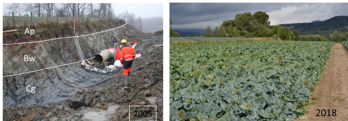
Figur 18 Vannledningsgrøft i Lierdalen med inntegnede sjiktgrenser i jordprofilen (til v.) og reetablert jordbruksareal med kålvekster (til h.) (Foto: Trond Knapp Haraldsen).
