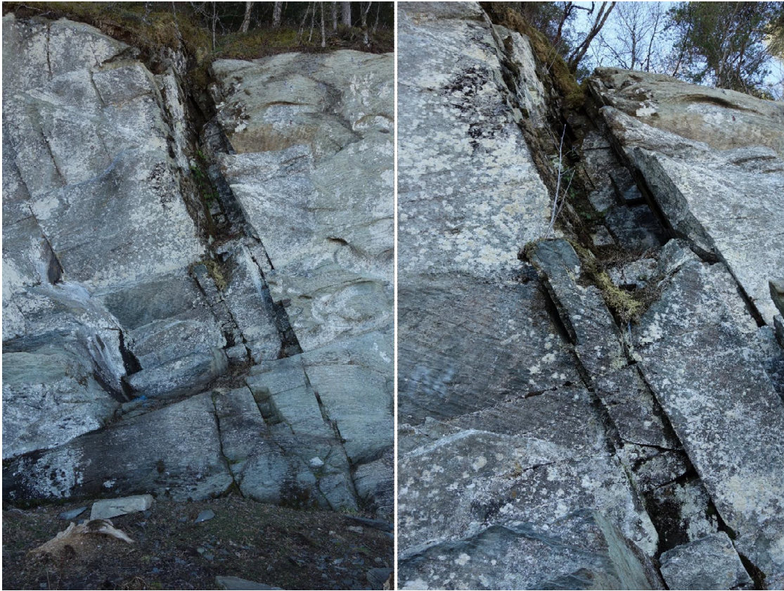
Bilde 18: Lokalitet 14. Sprekk med potensielt avløste blokker ved GPS 578 på New Wave. Høyre bilde: Nærbilde opp sprekken. Årlig observasjon og rensk anbefales.
