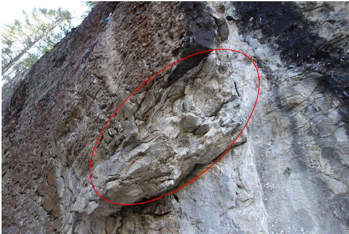
Bilde 10: Lokalitet 7. Overhengende parti mellom rutene Eksoristen og Pornodiederet med muligheter for utfall. Årlig observasjon anbefales inntil tiltak utføres.
