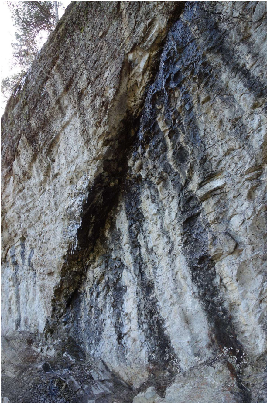
Bilde 8: Lokaltet 5. GPS 572 ved «Tabulator» og «Soma». Underkuttende sprekk med vann og is og sprekker i bergmasse som kan gi utfall. Observasjon årlig inntil rensk eller bolting.
