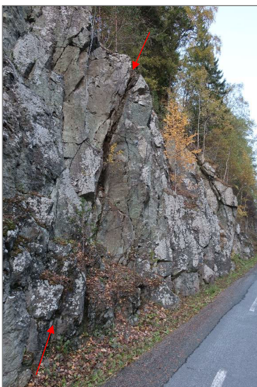
Figur 9 Svakhetsone i eksisterende skjæring ved profil ca. -300.
