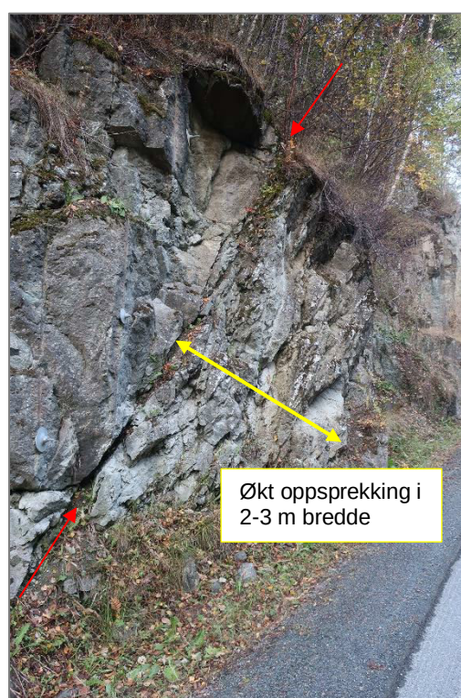
Figur 10 Svakhetsone i eksisterende skjæring ved profil ca. -320. Avgrensende sleppe i venstre side vist med pil.
